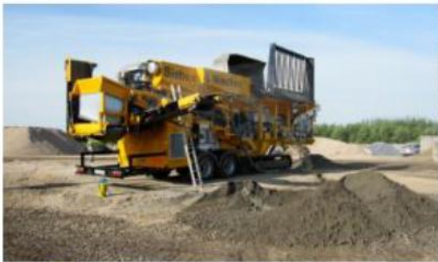
Foto: Kalkstabiliseringsanlæg- Backers anlæg 3-mtbc
