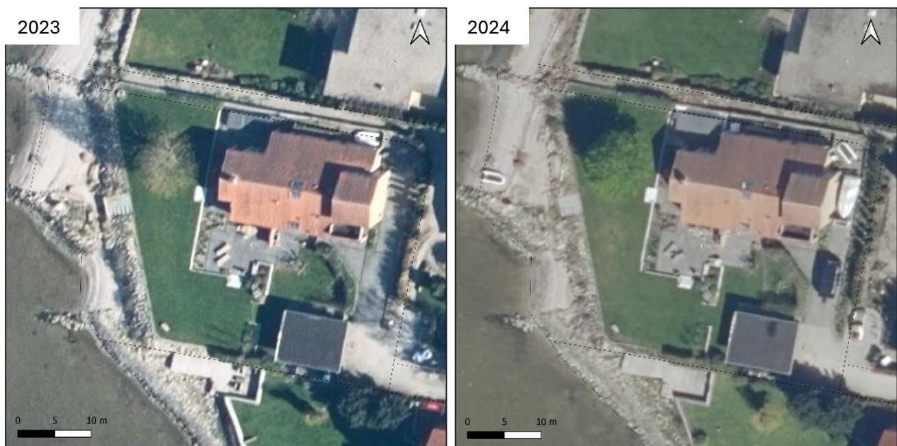
Figur 4.7: Frederiksborgvej 101A, skader på skråningsbeskyttelse efter stormen Pia i december 2023.
