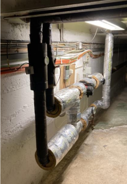
Figur 3.1: Eksisterende radiatorblandesløjfe i ingeniørgang under bygning 24.
