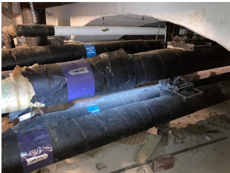
Figur 3.3: Hovedledninger i ingeniørkælder i knudepunkt ml. bygning 25, 27 og 28, hvor nye forsyningsledninger tilsluttes
