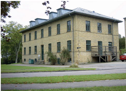
Fig.21. I sydgavlen er der etableret en udgang med en træterasse. Terrassen skal nedrives, og døren kan enten omdannes til fransk altan eller nyt vindue. © STARBAS
