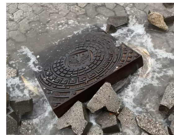
Det fyldte bassin på Elmevej dræner mod boligerne nord for (øverst); Oversvømmelsen på Vestre Kirkevej 2 (midten); Eksempel på kloakdæksel som er blevet skudt op af vandtrykket nedefra (nederst)
