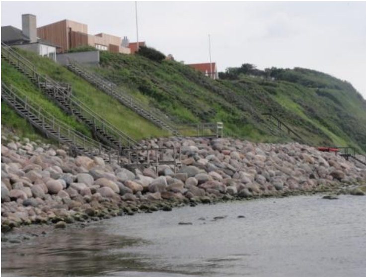
Vandet er blevet dybere ud for anlægget og stranden er forsvundet på grund af fortsat erosion
