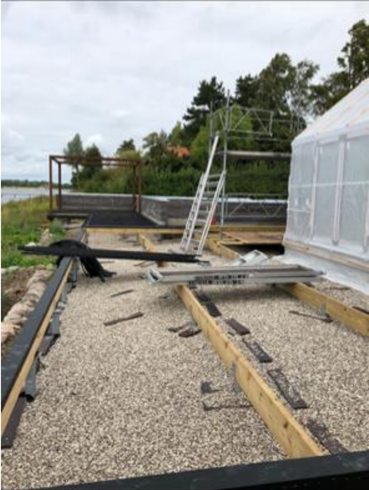
Figur 1.4: Foto af byggefasen af terrasseanlægget hvor den oprindelige mur kan ses fjordværts anlægget.
