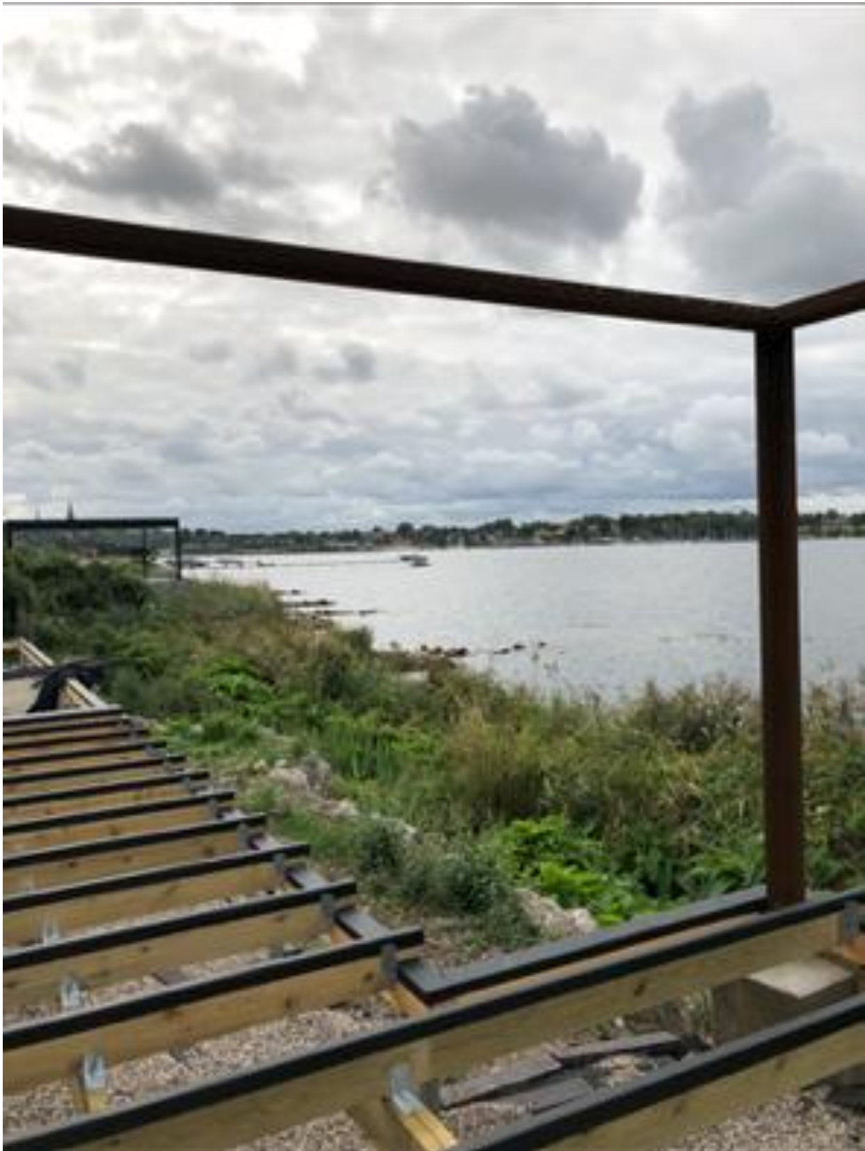
Figur 1.5: Foto af byggefasen af terrasseanlægget hvor den oprindelige mur kan ses fjordværts anlægget.
