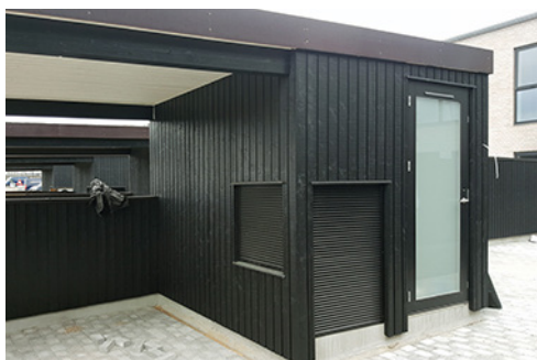
Fig.12. Varmepumper og andre tekniske installationer skal integreres i bebyggelse eller sekundær bebyggelse. Det kan ske som her, hvor varmepumpen er placeret i et udhus. © Lind & Risør A/S.
