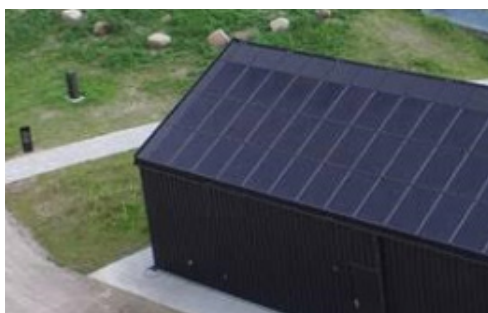
Fig.13. Solceller integreret i tagflader.
