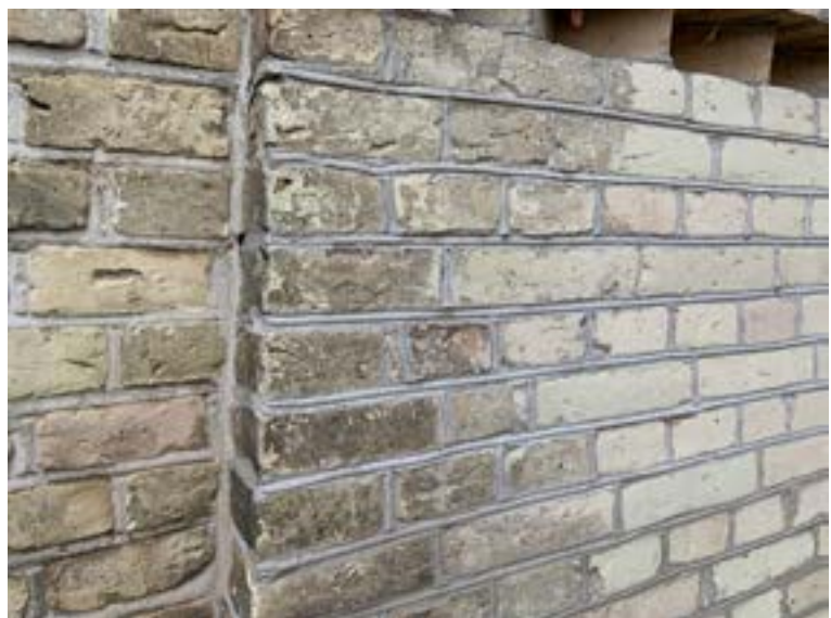
Fig.38. Det er vigtigt at fastholde bygningsdetaljerne, så nyt passer til gammelt. Det gælder skiftegangen - også kaldet forbandtet - og teglstenenes format, farve, tekstur og patina. Det gælder også fugetypen. Fotografiet viser, hvordan skiftegang og brændte fugetype er fastholdt ved en reparation af facaden. Her er brugt en skiftegang med rækker af skiftevis løbere (langsiden på teglstenen) og kopper (den korte side af teglstenen). Fotografiet viser også, hvor tydeligt en reparation skiller sig ud, hvis man ikke rammer rigtigt med stenenes farve.
