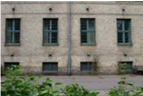
Fig.35. Tagrender og nedløbsrør skal udføres i zink uden synlig overfladebehandling. For at tilpasse tagrender og nedløbsrør til de bevaringsværdige bygninger bør de udføres med samme detaljering og befæstigelse som oprindeligt med loddede eller faldede samlinger og knæk (bajonetknæk). Rendejern bør udføres med vulst.
